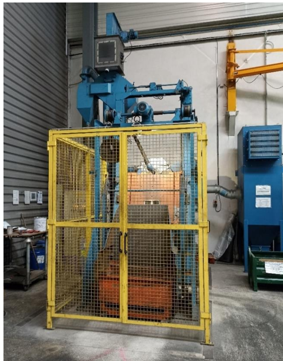
Figure 10 : Photographie des installations de grenailage
