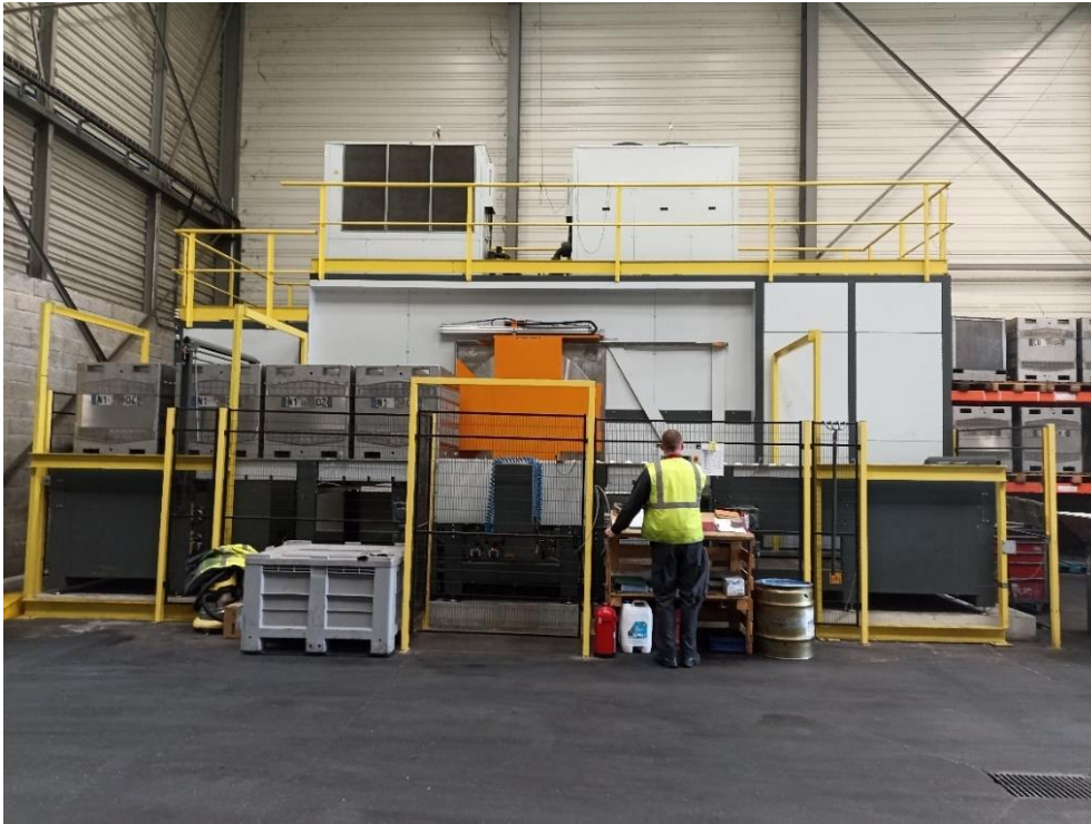
Figure 12 : Photographie de l'installation de dégraissage
